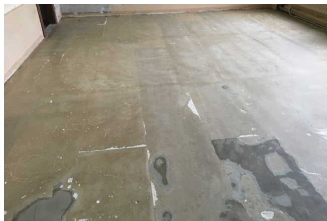
Starý podklad, který vyžaduje sanaci.
